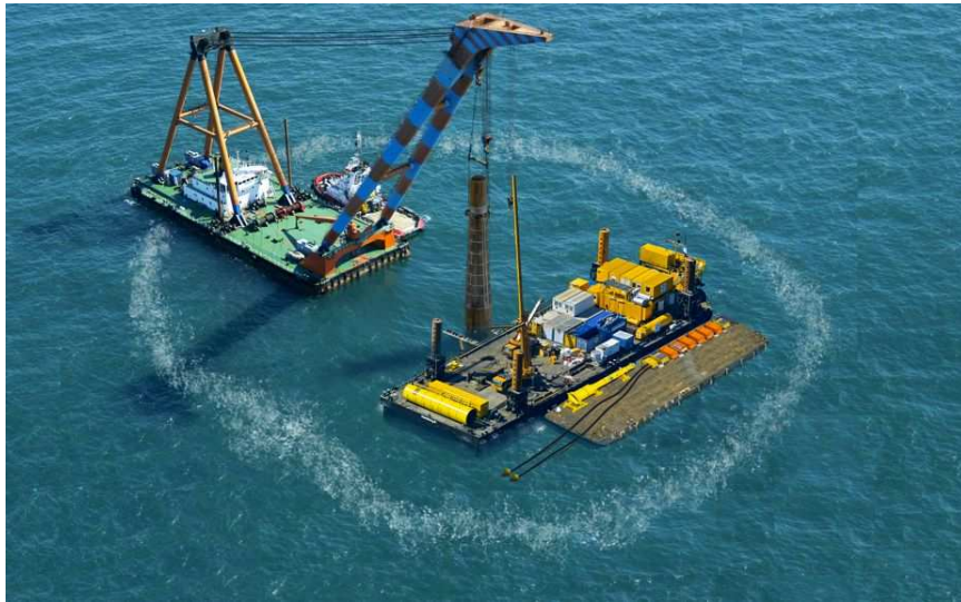
Figure 20 : . Rideau de bulles déployé autour d'une structure en Mer du Nord (source : HYDROTECHNIK LÜBECK)
