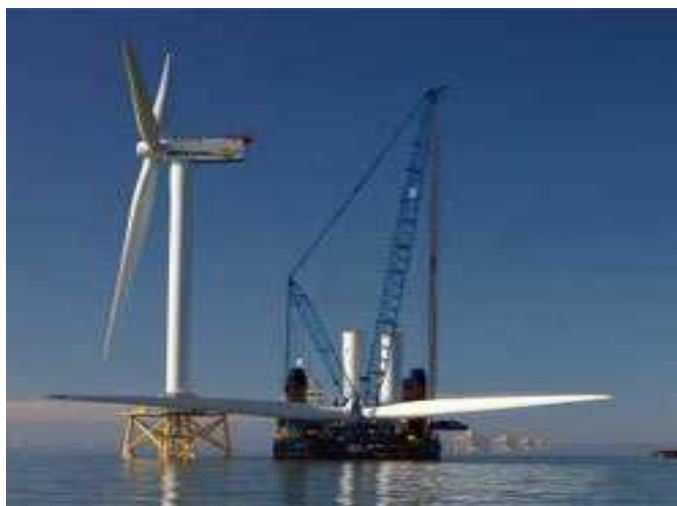
Figure 7 : Travaux de construction du parc éolien en mer d'Ormonde (Royaume-Uni – source : http://www.enerzine.com )
